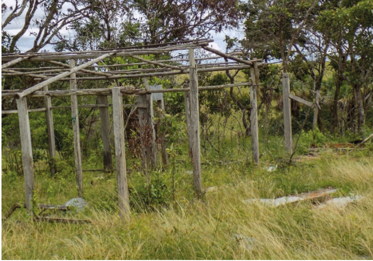
Figura 3. Casas abandonadas a causa de la guerra.
