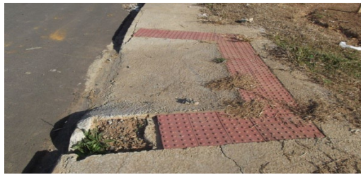
Fotos 4-5. Iluminação e vias pavimentadas com passeio e rampas de acesso para PcD física neuromotora que utilizam cadeiras de roda e piso podó tátil de alerta para deficientes visuais nos Jardins Atenas e Roma em Ponta Grossa-PR. Fonte: Lombardi (2013).
